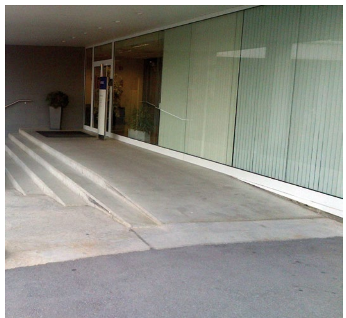
Se muestra una rampa para salvar la escalera de acceso. A destacar que el último peldaño se encuentra en rampa en su parte de conexión con la plataforma, a la que llega la rampa que va cortando los peldaños de la escalera. (Fotografía cedida por Grifols)
