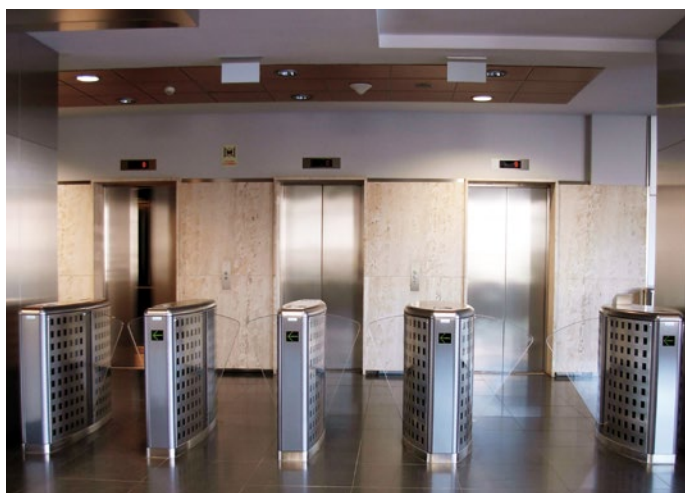
MECANISMO DE CONTROL DE ACCESOS MEDIANTE TORNOS
